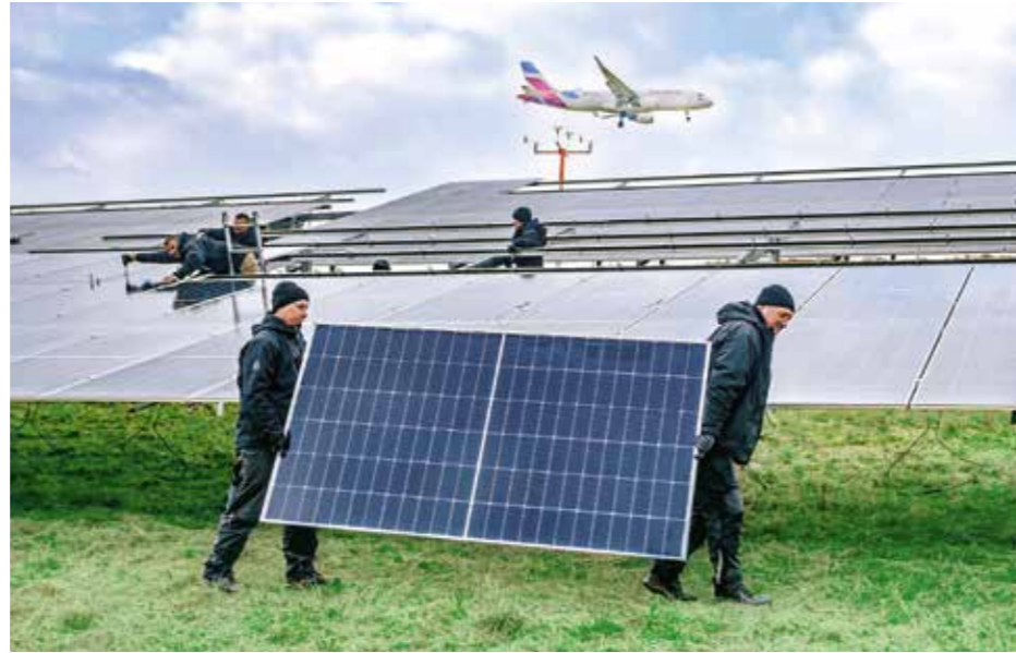
↑ Im Jubiläumsjahr 2024 wurde die siebte Photovoltaikanlage am Airport in Betrieb genommen.
